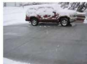
przykład wykonanej i funkcjonującej instalacji pod nawierzchnią parkingu
